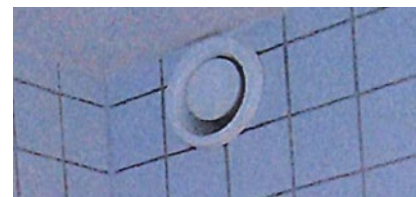
Grundutförande frånluftdon över spisen
